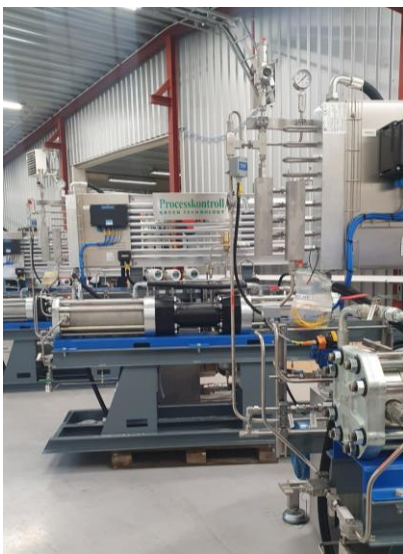
Wasserstoffverdichterstationen für die Verdichtung von H 2 auf bis zu 500 bar
